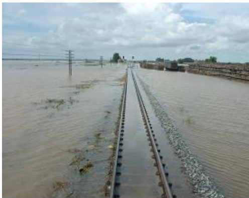
รูปที่ 1 สภาพน้ำท่วมคันทางรถไฟหลักเสาโทรเลขที่ 309/2
