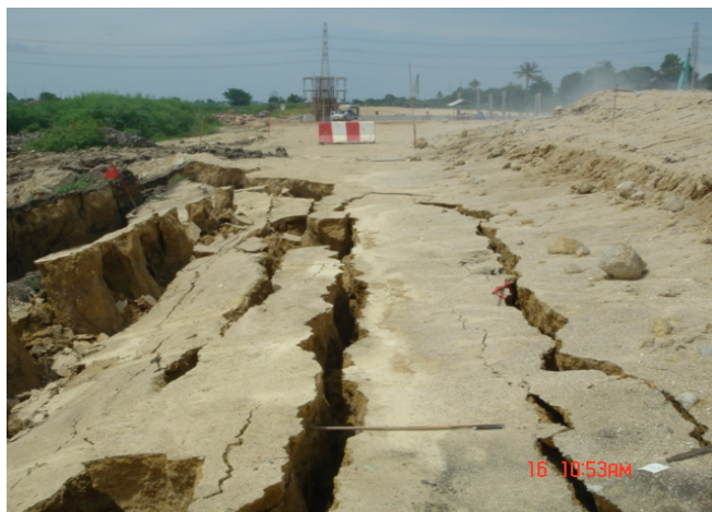
ภาพที่ 10 ตำแหน่งที่เกิดการพังของการก่อสร้างเสาเข็มดิน-ซีเมนต์ ภายในโครงการระบายน้ำบริเวณสนามบินสุวรรณภูมิ
