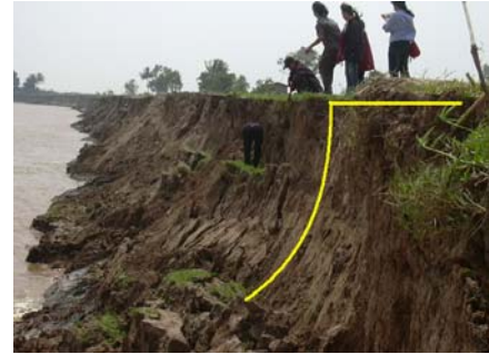
ภาพที่ 2 การพิบัติของตลิ่ง บ.คอนนางหงส์ อ.ธาตุพนม จ.นครพนม
