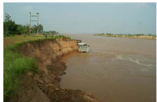
ภาพที่ 8 สภาพตลิ่งบริเวณหัวเขื่อนป้องกันตลิ่งที่บ้านนาทาม จ.นครพนม
