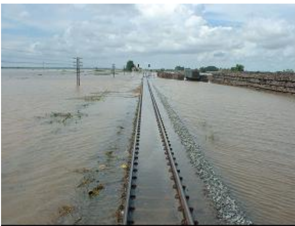
รูปที่ 2 สภาพน้ำท่วมสูง ที่ กม. 309/2
