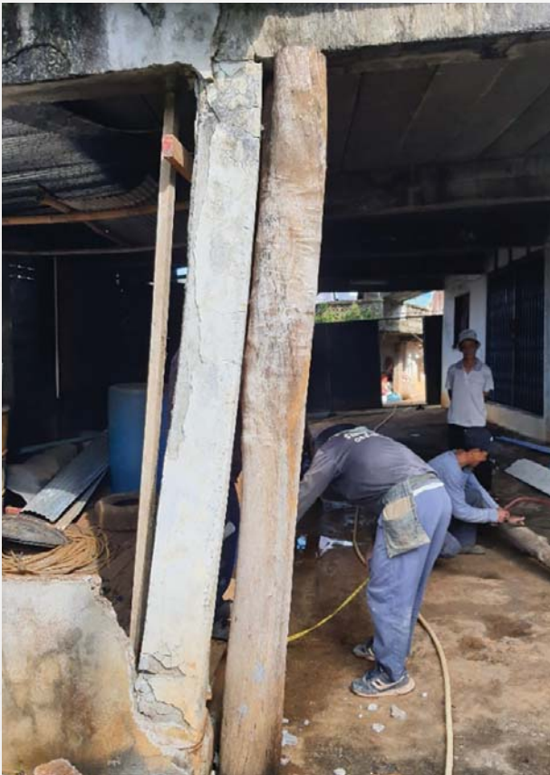
รูปที่ 17 การค้ำยันเสา ก่อนการรื้อเสาเดิม
