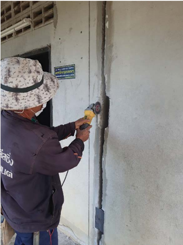
รูปที่ 9 การสกัดปูนบริเวณรอยแยกของเสา
