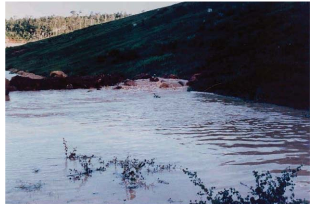
รูปที่ 2 - จุดรั่วที่ 1 - Sta. 0+856 ระดับที่ไหลออกจากจุดรั่วสูงกว่าระดับหลังของ Rockfill Toe - วันที่ 24 ตุลาคม 2533
