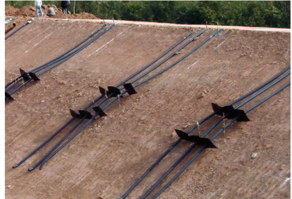
รูปที่ 18 ลักษณะท่อและแผ่น HDPE ที่ใช้ก่อสร้างจริง
