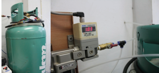
รูปที่ 7 ลักษณะของถังพักลม และ Digital Regulator
