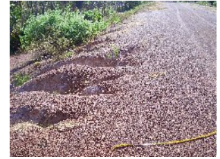
(ข) การกัดเซาะลาดคันดินถมของถนนที่อยู่บริเวณใกล้เคียง
