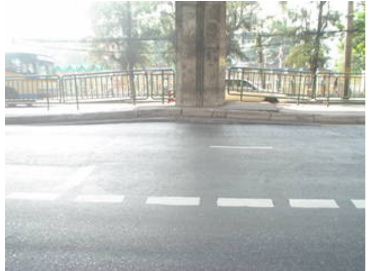
รูปที่ 1 การทรุดตัวต่างกันระหว่างถนนและทางยกระดับ ณ บริเวณหน้ามหาวิทยาลัยรามคำแหง
